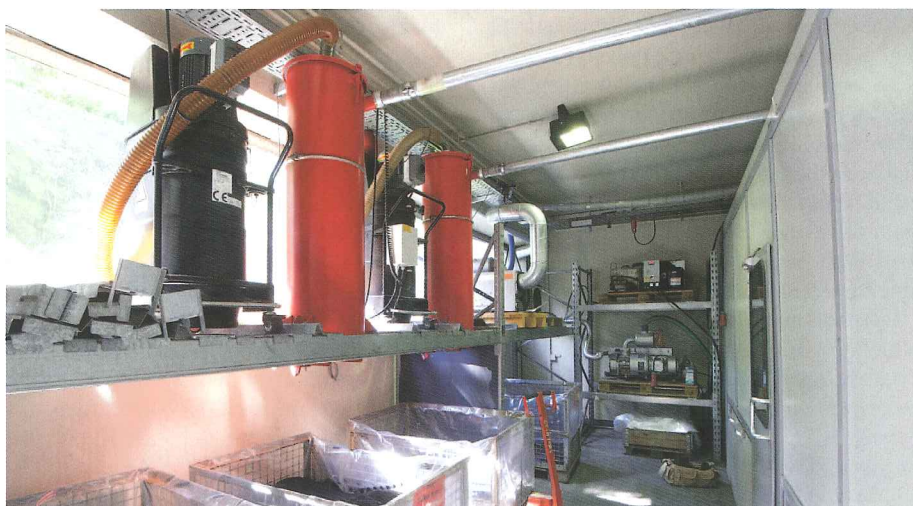
Der Zyklonabscheider übernimmt die rein mechanische Vorabscheidung, das Filter des nachgeschalteten Saugers wird kaum belastet
